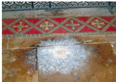
Рис. 13. Повреждение каменных плит в Пенмонском монастыре, Уэльс, Великобритания, из-за длительного попадания на них мочи рукокрылых.
