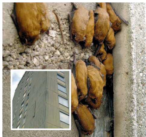
Рис. 12. Многоквартирный дом в Словении с убежищем Nyctalus noctula под наружной облицовкой, обнаруженным только после начала ремонтных работ.
